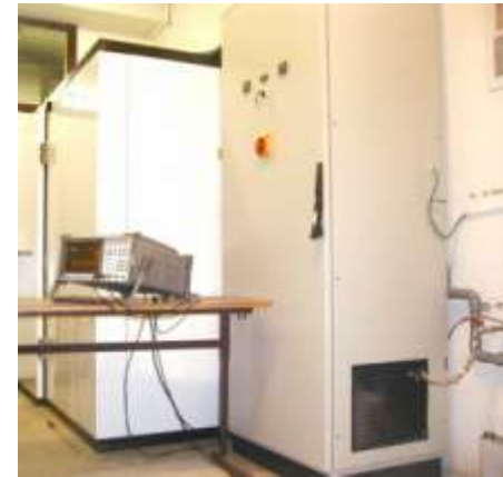
Chambre régulée en température et en hygrométrie
